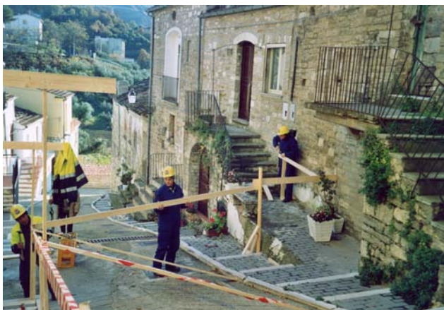
22 Novembre 2002 Transennamento delle case di Monacilioni
