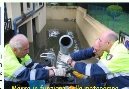
Messa in funzione della motopompa
