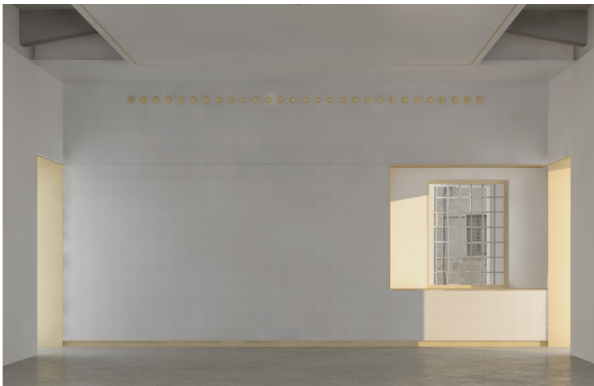
66_ controparete impiantistica al primo piano: alla base la griglia di ripresa, alla sommità il plenum di mandata con ugelli a lunga gittata
