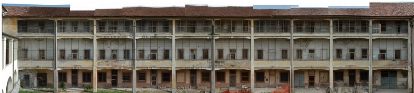
10_ fotopiano della facciata sud prima del consolidamento del telaio del ballatoio con demolizione del parapetto (anno 2014)
