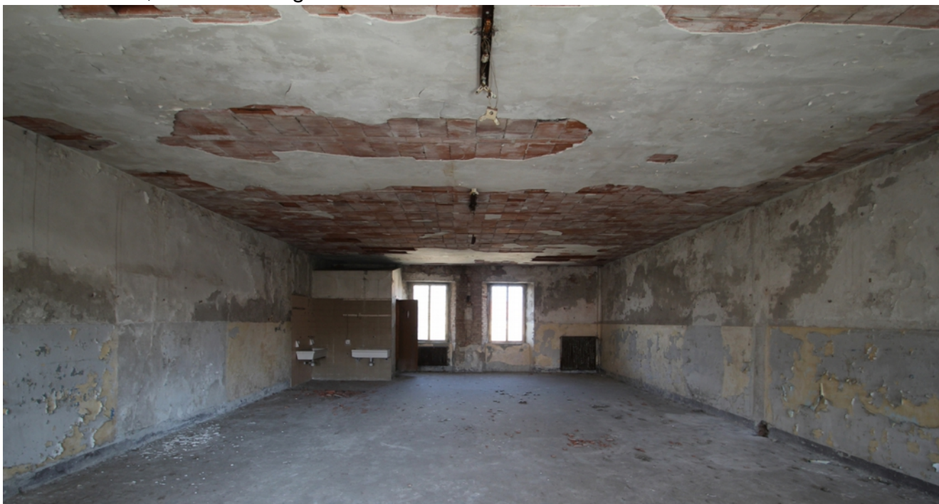
16_ fotografia di una sala tipo del secondo piano, verso nord; a sinistra il blocco dei servizi; in alto il solaio in laterizio armato tipo cirex con pericolo di sfondellamento
