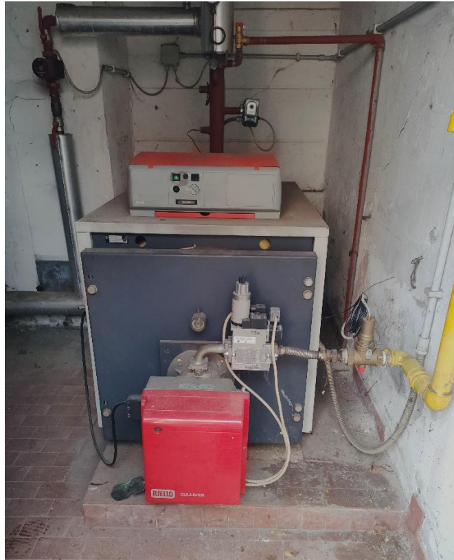
Figura 7 – Fotografia 05: centrale termica
