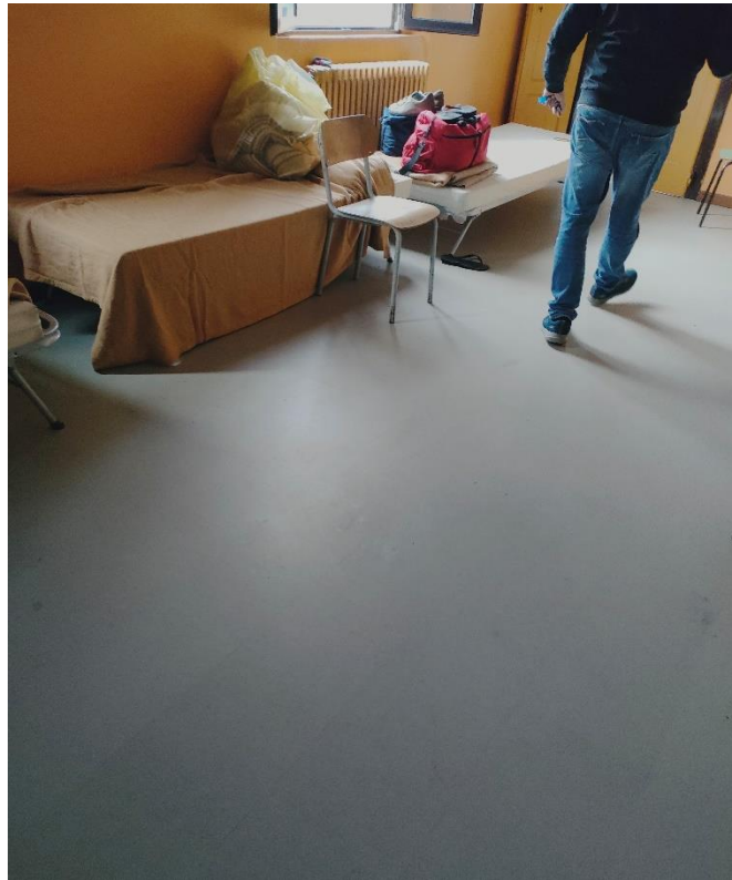
Figura 11 – Fotografia 09 soggiorno – solaio da consolidare
