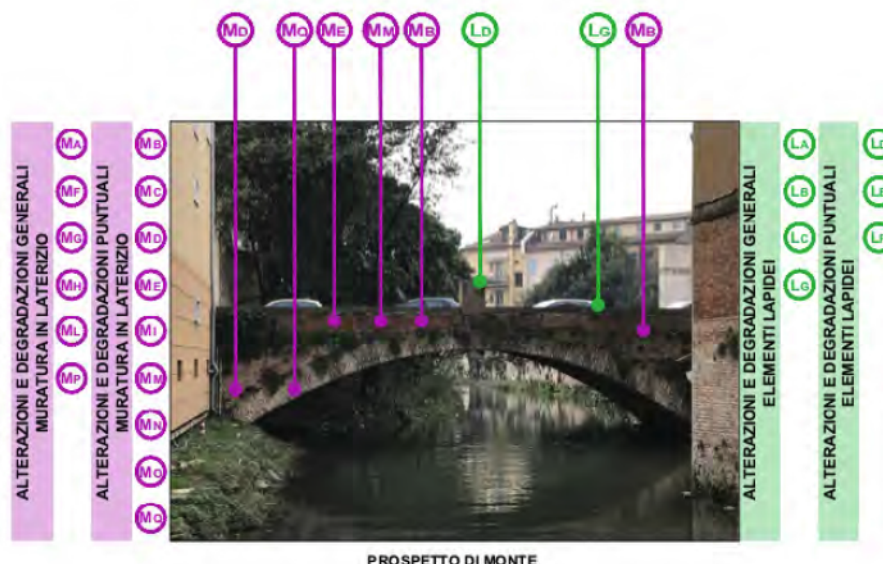
Figura n. 11 – Stato delle alterazioni e degrado prospetto di monte
