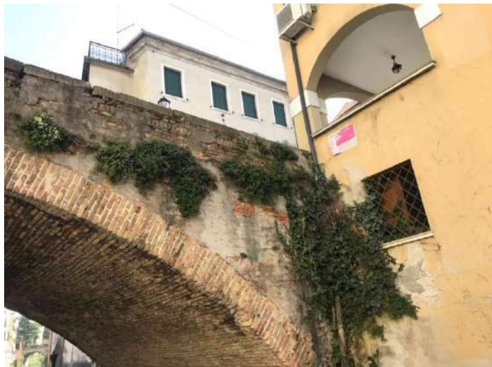
F06 Timpano, parapetto a monte
