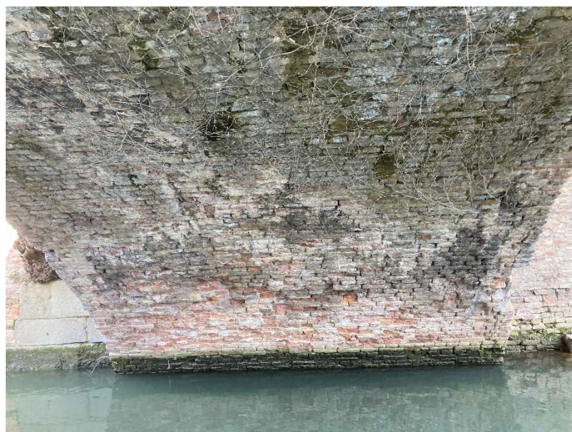
Foto 08 – Intradosso volta in destra idraulica
