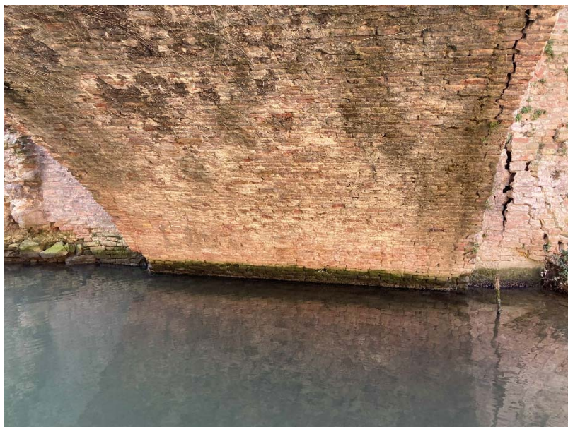
Foto 07 – Intradosso volta in destra idraulica
