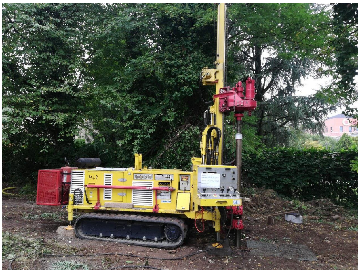
Figura 11 – Sonda approntata nel sondaggio Pz_4.
