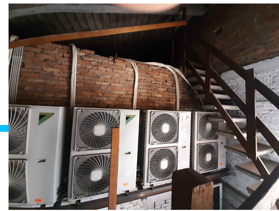
Foto stato di fatto n.5 unità esterne
