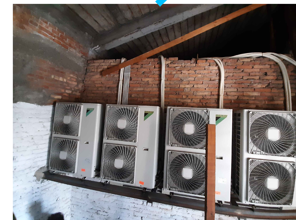
Foto stato di fatto n.5 unità esterne
