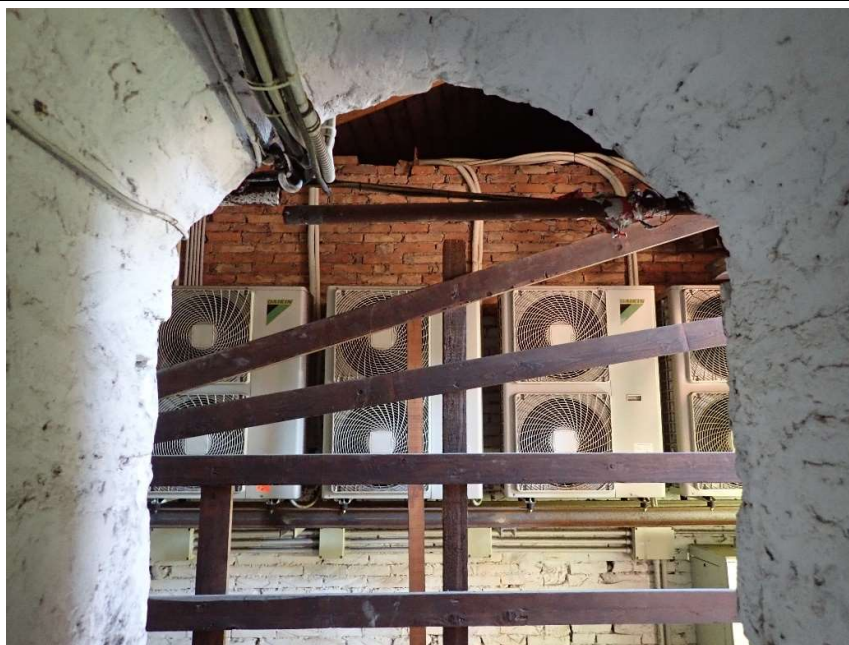
Particolare degli impianti attualmente presenti lungo il percorso di accesso e di cui è previsto lo spostamento
