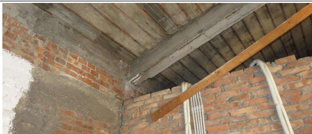
In corrispondenza dell'appoggio basso (lato nord) la trave poggia su un cordolo continuo in c.a.
