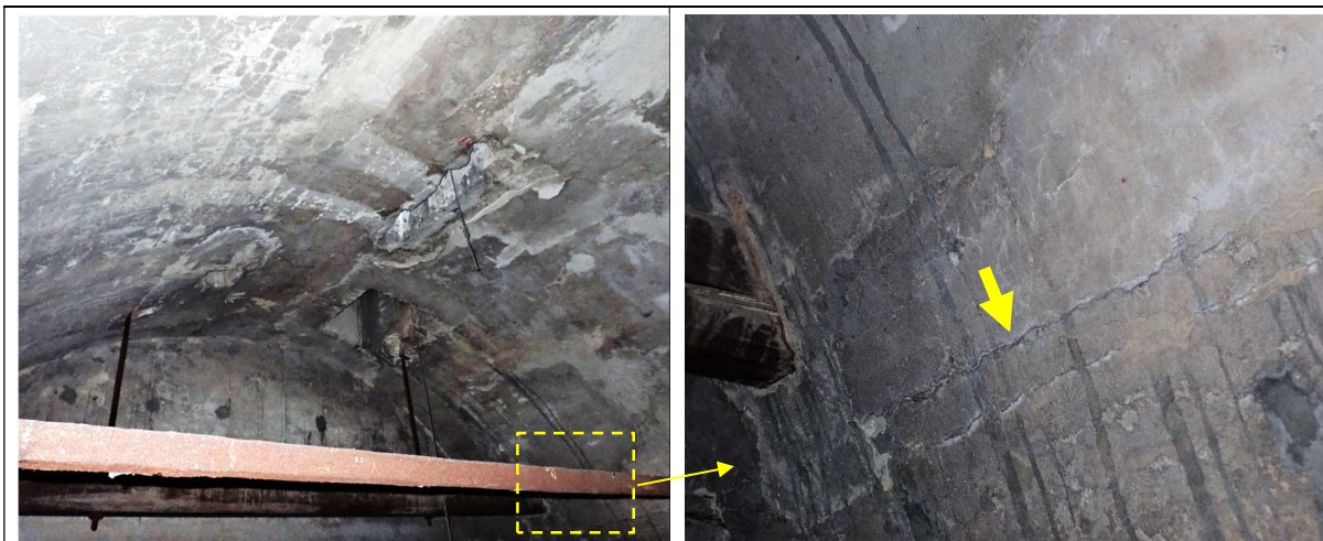
Vista dell'intradosso della volta con evidenziato uno dei sistemi di lesioni
