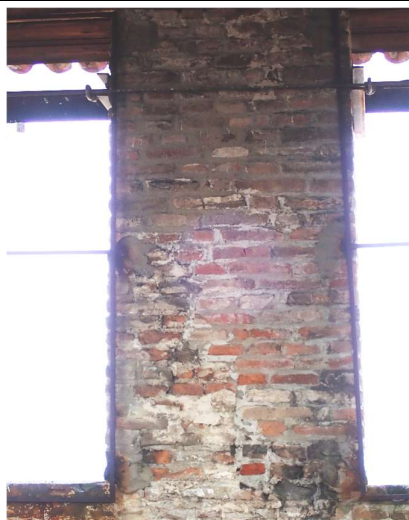
Vista di una delle merlature. Si nota che la muratura non risulta omogenea e sembra composta da parti realizzate con materiali diversi
