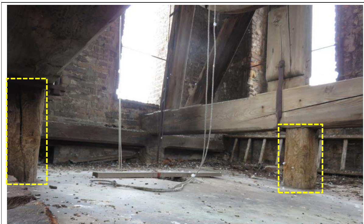
Particolare della cella campanaria con evidenziati gli elementi in legno inseriti come puntellazione
