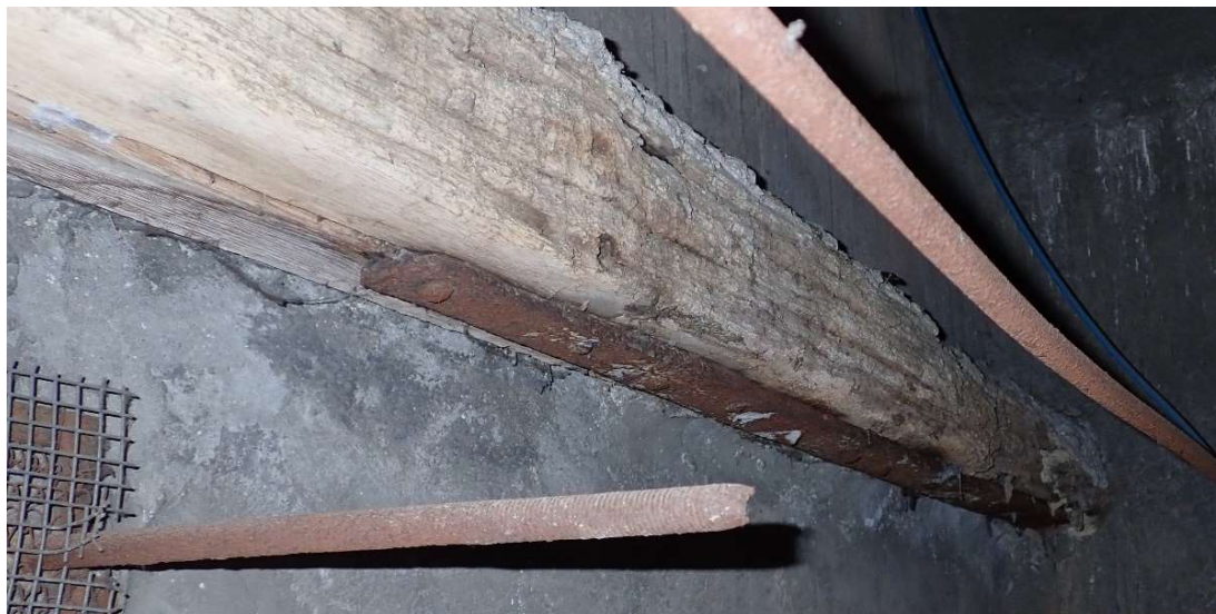
Particolare catena storica composta da una trave lignea sui quali sono chiodate le estremità metalliche. La trave lignea presenta evidenti segni di degrado.
