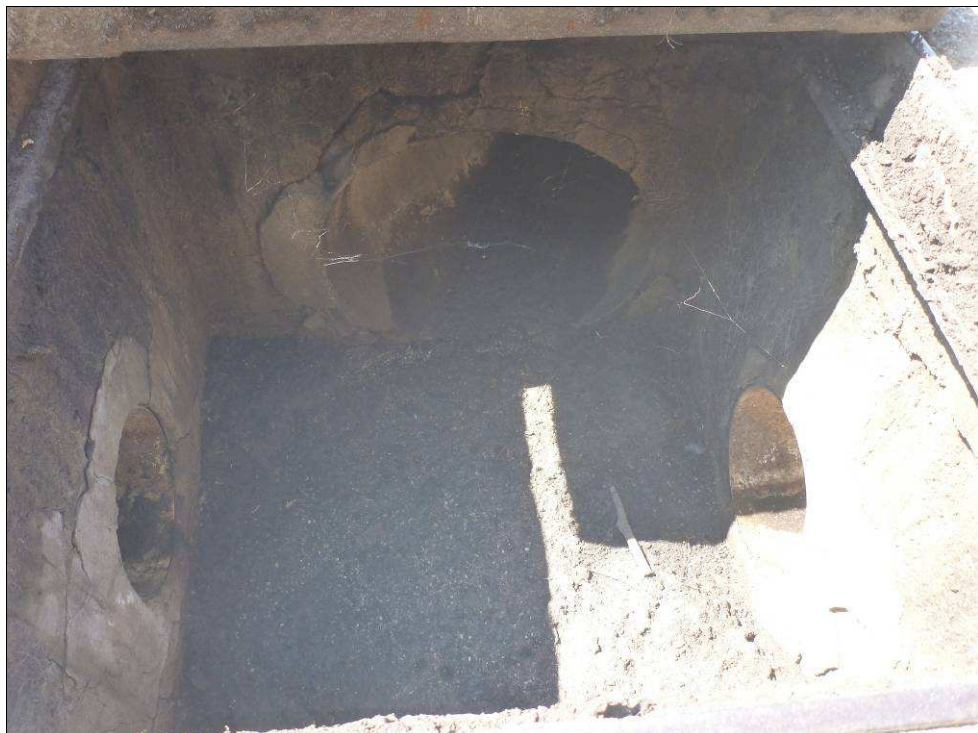
Figura 26. Pozzetto di ispezione delle acque meteoriche presente in via Jacopo Cavacio la cui linea principale è rappresentata da una condotta in pvc Ø 350 mm; vista in direzione nord-ovest.
