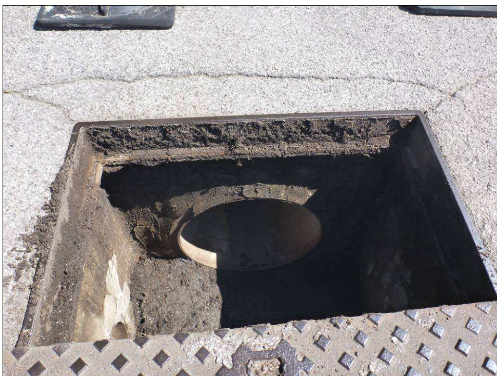
Figura 27. Pozzetto di ispezione delle acque meteoriche presente in via Jacopo Cavacio la cui linea principale è rappresentata da una condotta in pvc Ø 350 mm; vista in direzione sud-est.
