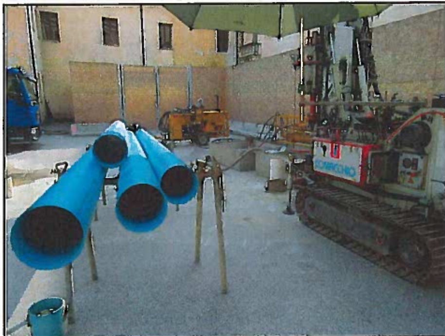
Piezometro di grandi dimensioni
