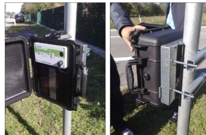
Figura 152 – RADAR SDR-Easydata – Esempio di installazione
